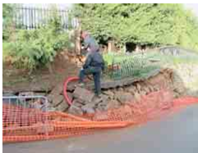
IL MURO CROLLATO VENERDÌ SERA IN VIA SAN GIULIANO
